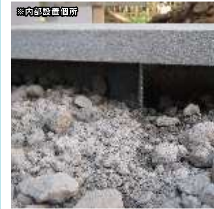
※内部設置箇所
